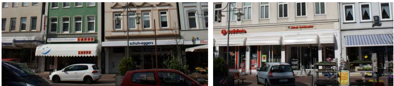
Abbildung 33: Beispiele für die Vielfalt und Störwirkung von Vordächern und Markisen (links unten); Positive Beispiele für Markisen/Vordächern mit Bezug zur Fassadengliederung (rechts unten/oben)
