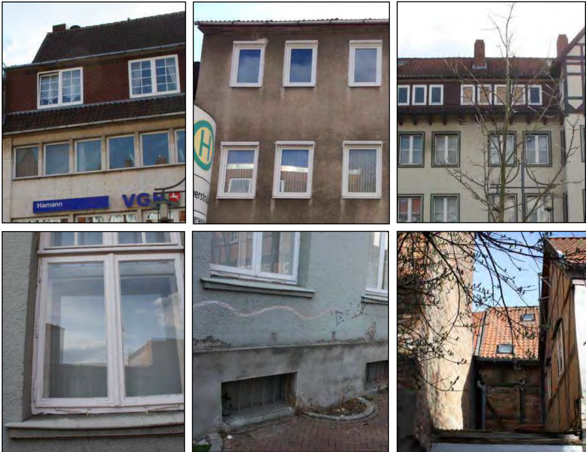
Abb. 34: Beispiele für Schäden an Dächern, Fenstern und Fassaden der Gebäude
