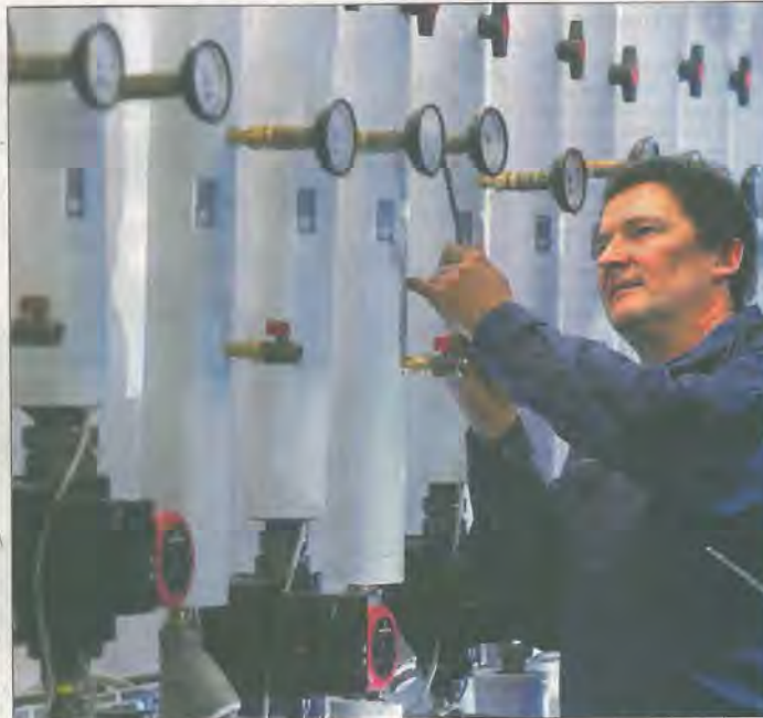
Ein Blockheizkraftwerk für ein größeres Zentrum – nach dem Klimaschutzkonzept sollen weitere Wärmeinseln in der Stadt Uelzen initiiert werden. Foto: dpa
